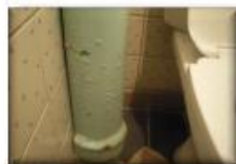
Conduites ou canalisations d'eau
